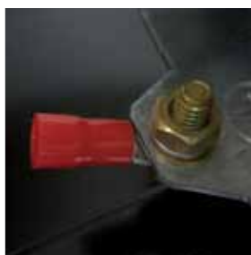
Toma de tierra
